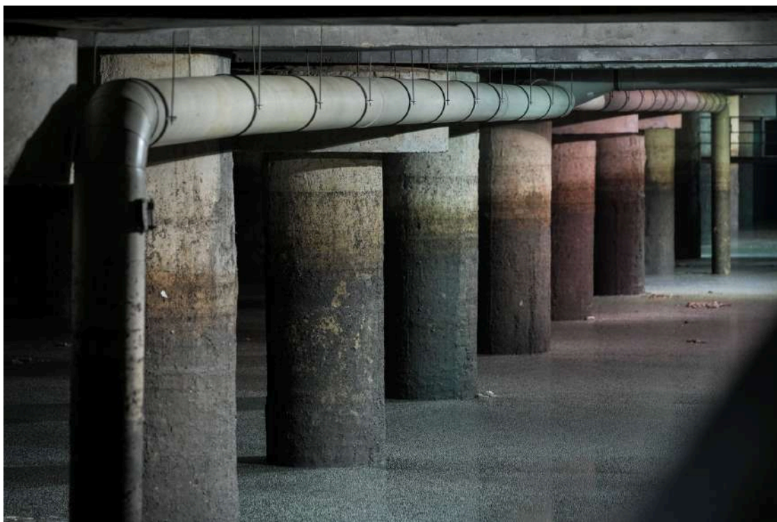
Tanques de tormenta Comunidad de Madrid
