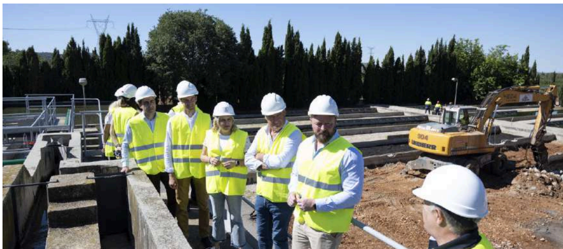
Imagen de la visita de la Diputación de Castellón a una de las depuradorasDiputación de Castellón
